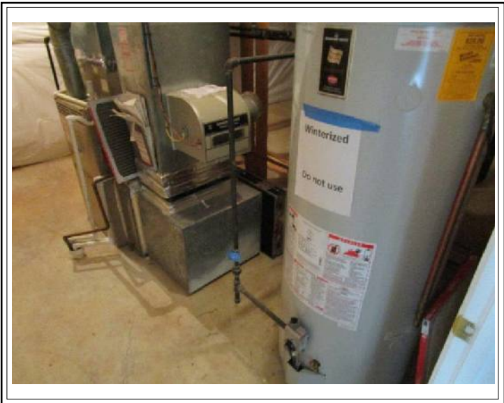
Basement - HVAC / HWH
